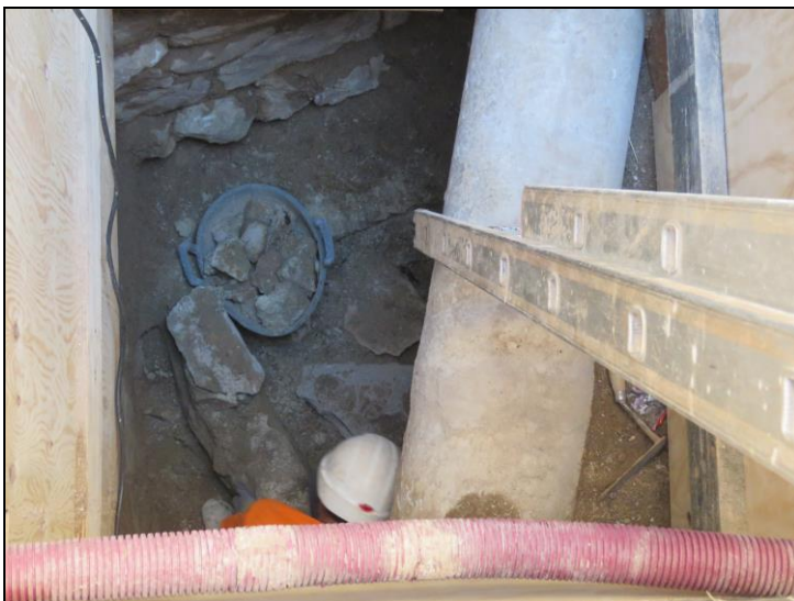
Afectació del dipòsit UE 118
